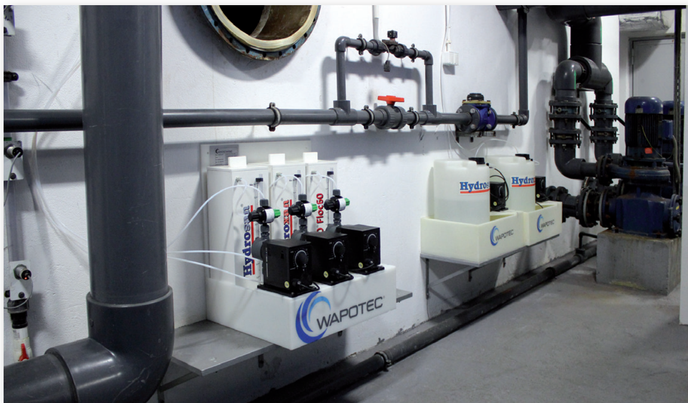
Standardowa instalacja uzdatniania wody basenowej rozszerzona o technologię WAPOTEC®SYSTEM
