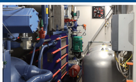
Najnowocześniejsza maszynownia amoniakalna, Toruń 2023
